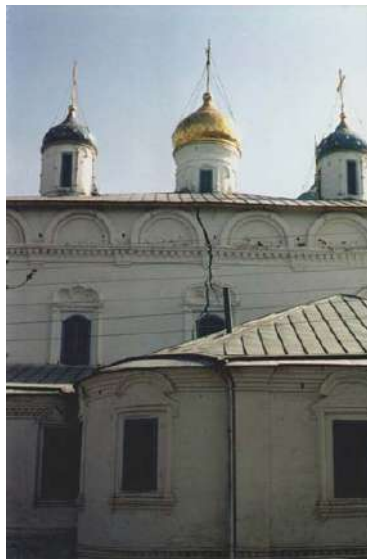
Рис. 1. Трещина над оконным проемом храма (северный фасад).
